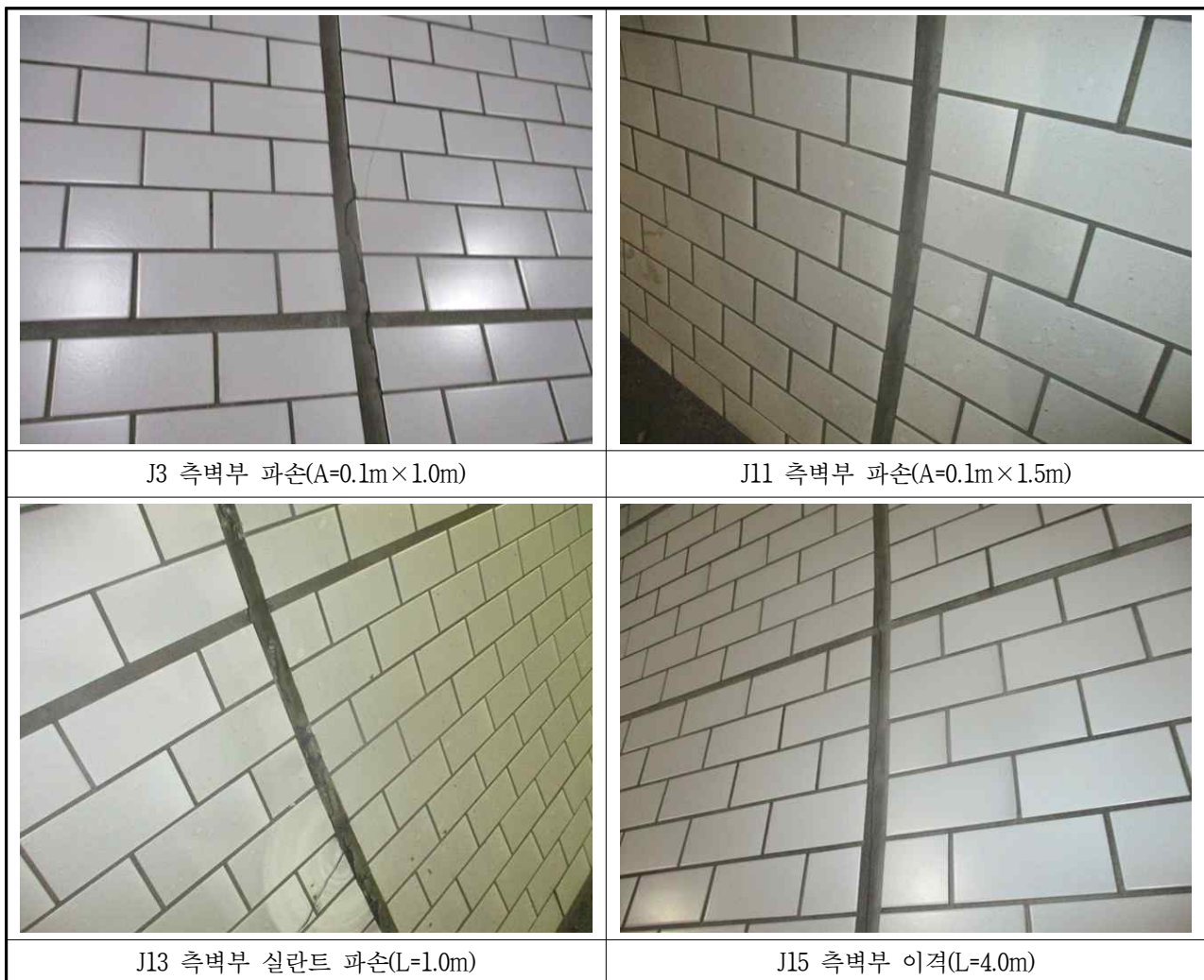
【사진 3.6】 측벽부 손상현황
